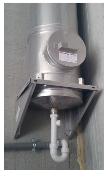
Trappe d'inspection avec évacuation du condensat
