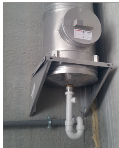
Inspectieluik incl. condensafvoer
