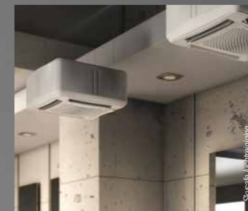
Vasco warmtepomp en boilers
